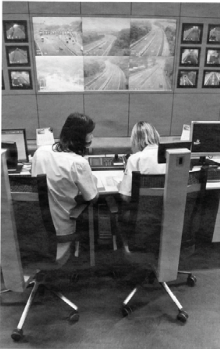
Dos operarias en el centro de gestión de tráfico ubicado en la sede de Bidegi, en Zarautz. UÑEZ
