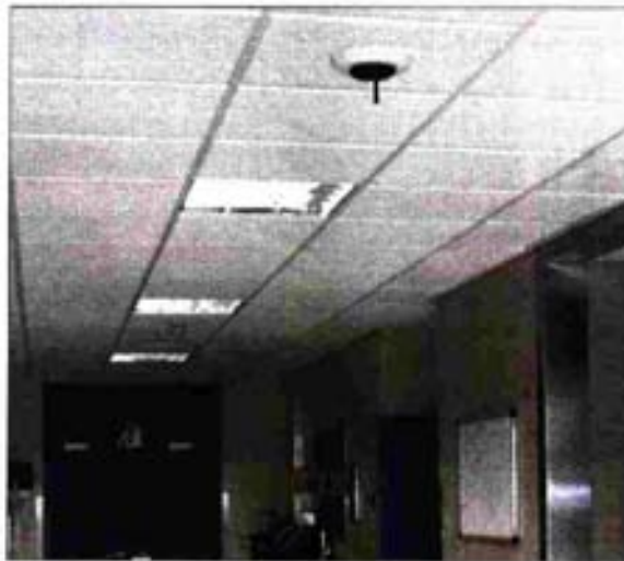
Detector de RFID en el techo de un pasillo del Santiago Apóstol.
